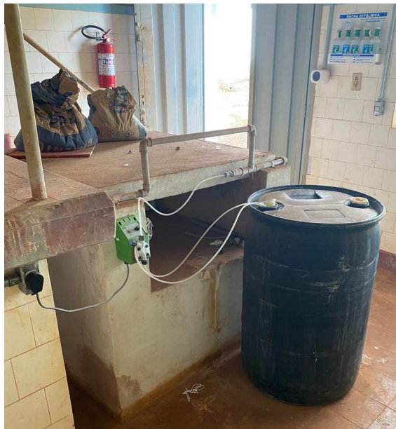
Figura 32 – Bomba dosadora de Flúor.
