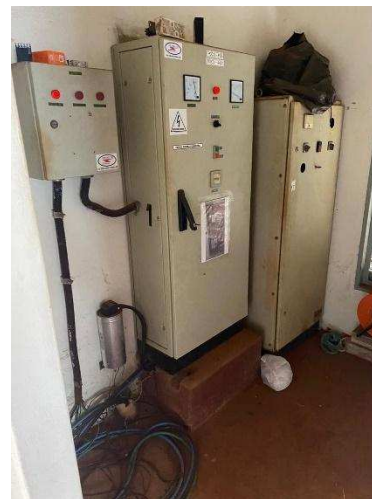
Figura 40 – Painéis de comando.
