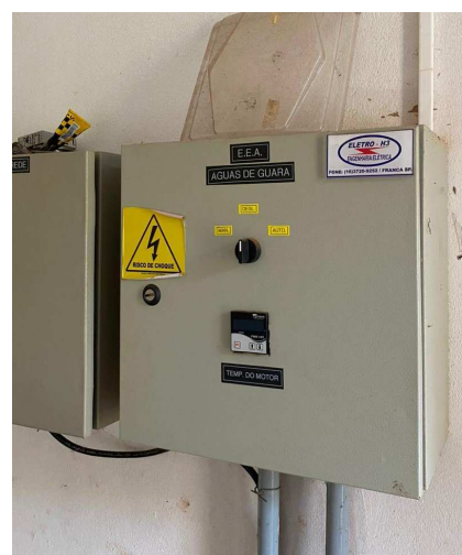
Figura 93 – Painel de comando.
