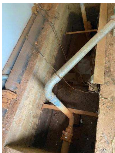
Figura 90 – Tubulaç4o Booster Itapema.
