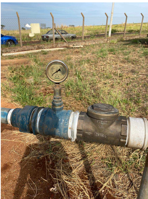
Figura 64 – Medidor de pressão – Poço UP 11.
