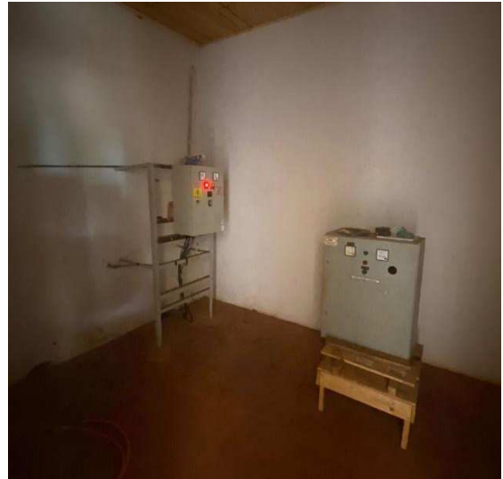
Figura 81 – Casa de m´quinas.
