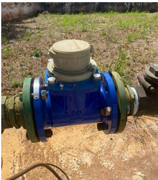
Figura 80 – Macromedidor UP Pioneiros.
