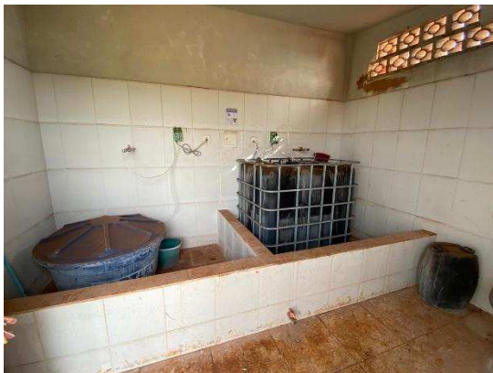
Figura 68 – Dosagem de cloro e flúor.
