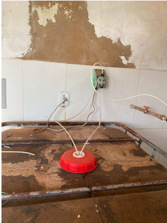
Figura 76 – Bomba dosadora de cloro.
