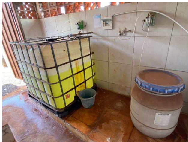
Figura 45 – Dosagem de cloro e flúor.
