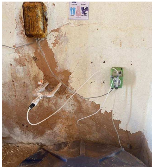
Figura 86 – Bomba dosadora de flúor.
