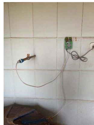
Figura 70 – Bomba dosadora de flúor.
