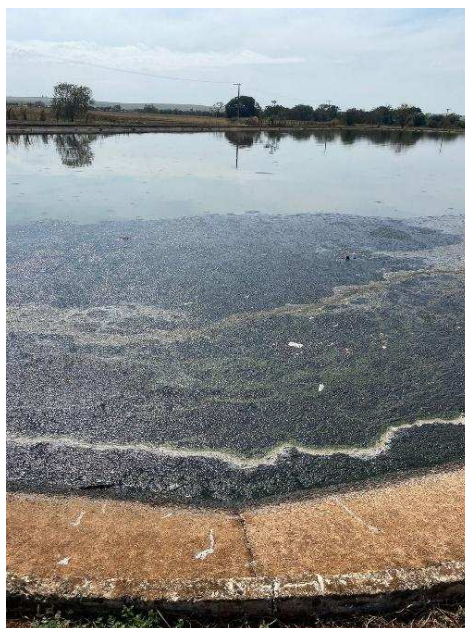
Figura 130 – Resíduos Sólidos no espelho da Lagoa Facultativa.
