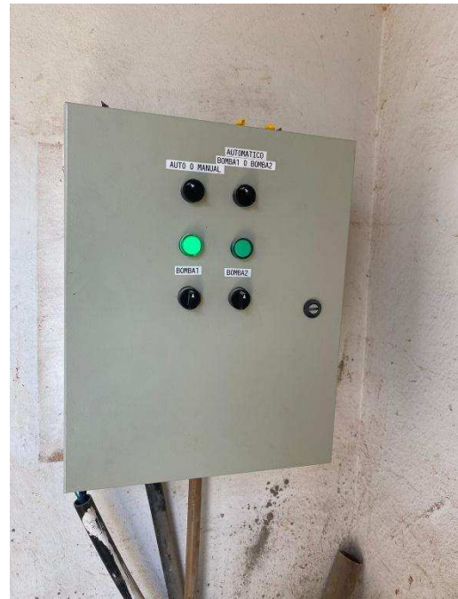
Figura 117 – Painel Elétrico da EEE Sete de Setembro.
