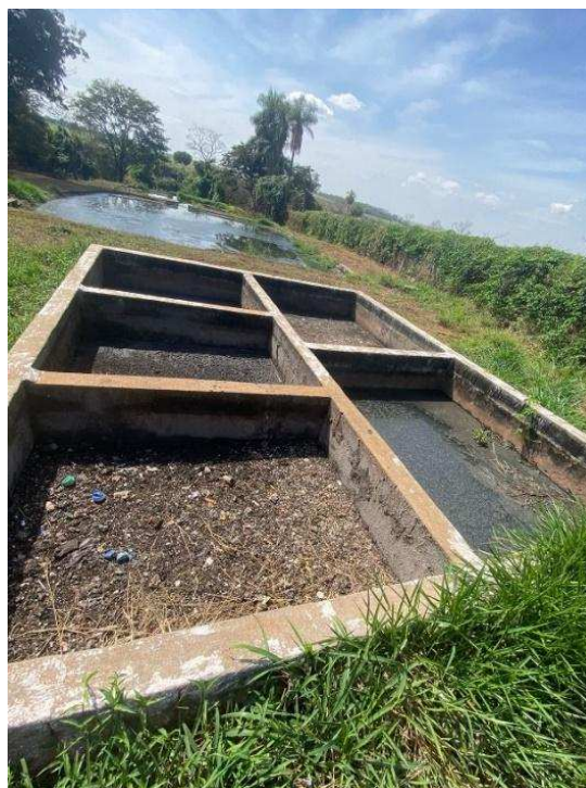
Figura 136 – Caixa de Recebimento de efluentes.
