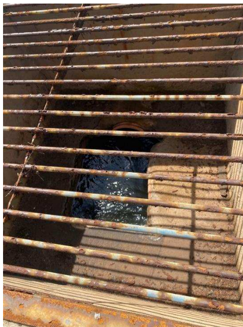
Figura 124 – Chegada do Efluente na ETE Guará.
