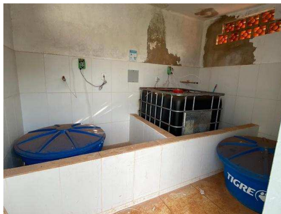
Figura 75 – Dosagem de cloro e flúor.
