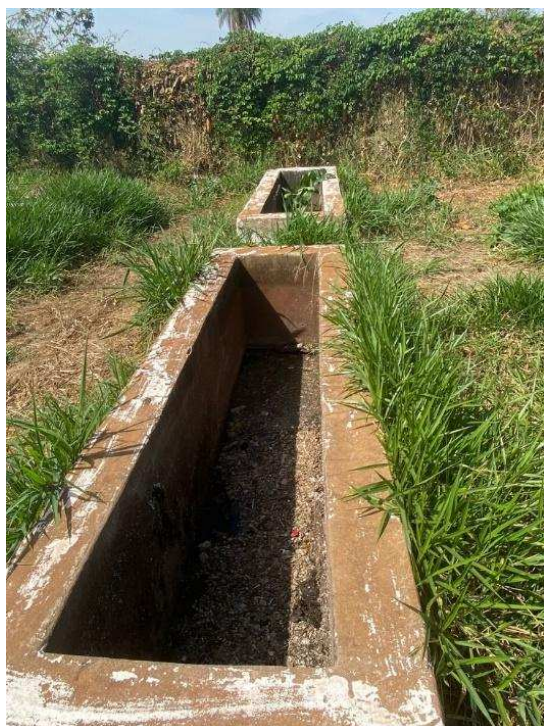
Figura 135 – Chegada do efluente na ETE Pioneiros.
