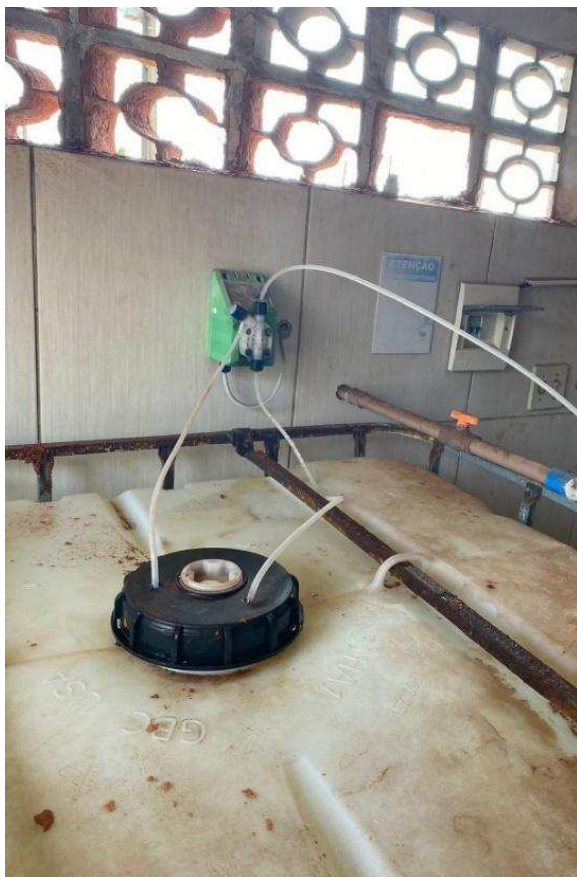
Figura 46 – Bomba dosadora de cloro.
