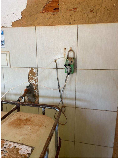
Figura 60 – Bomba dosadora de cloro.
