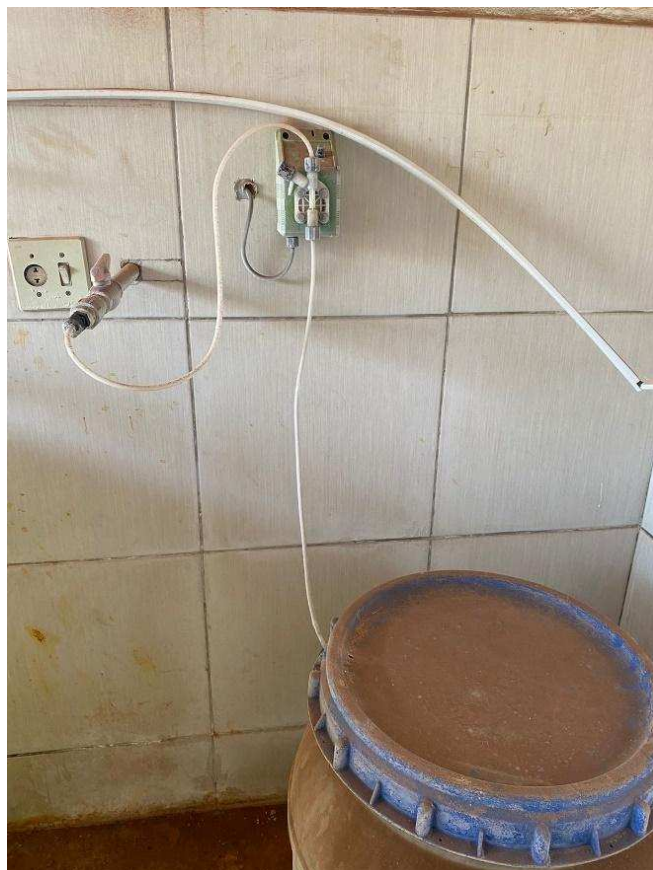
Figura 47 – Bomba dosadora de flúor.
