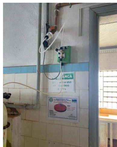
Figura 31 – Bomba dosadora de Cloro.
