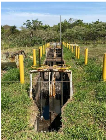
Figura 120 – Estação Elevatória de Esgoto da ETE Guará.
