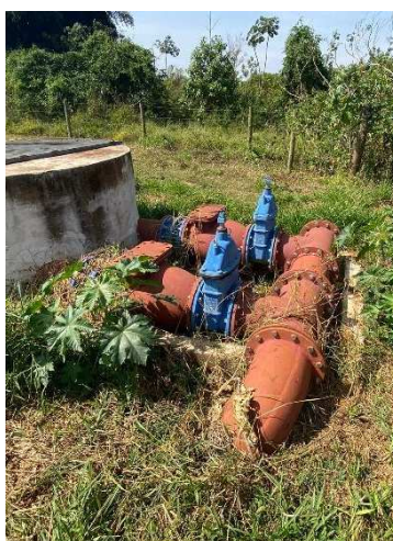
Figura 121 – Bombeamento da EEE da ETE Guará.
