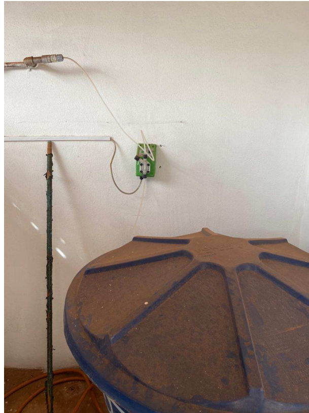
Figura 53 – Bomba dosadora de flúor.
