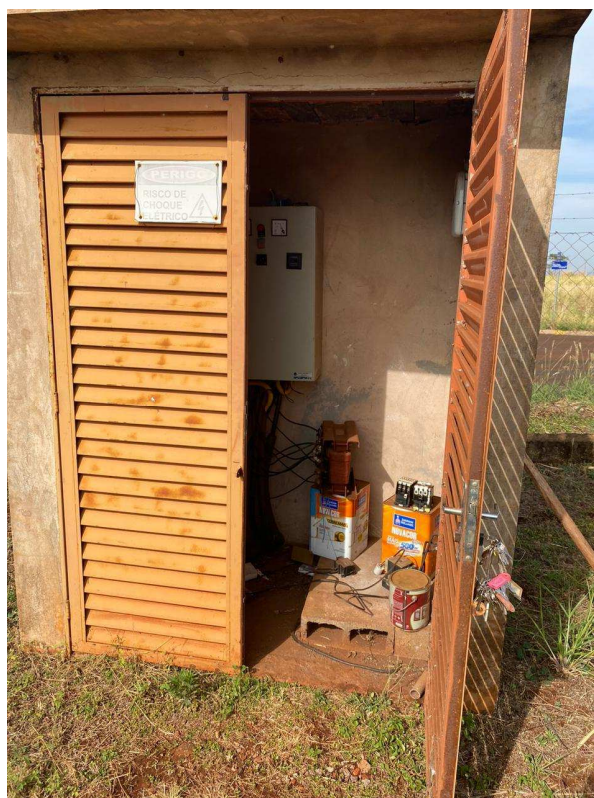
Figura 66 – Casa de máquinas.
