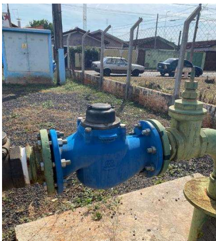
Figura 43 – Macromedidor Poço UP 08.
