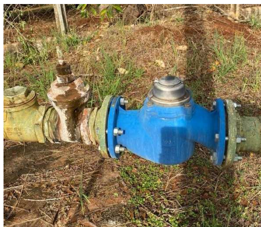
Figura 29 – Macromedidor Poço UP03.
