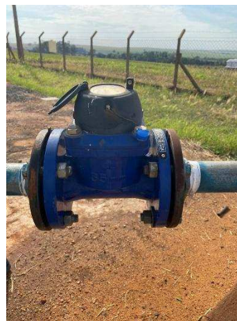
Figura 65 – Macromedidor poço UP 11.
