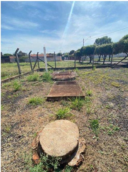
Figura 115 – Estação Elevatória de Esgoto Sete de Setembro.
