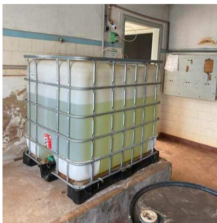
Figura 30 – Caixa de armazenamento de cloro.
