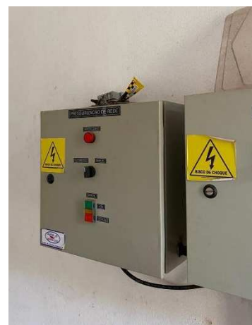
Figura 92 – Painel de comando.
