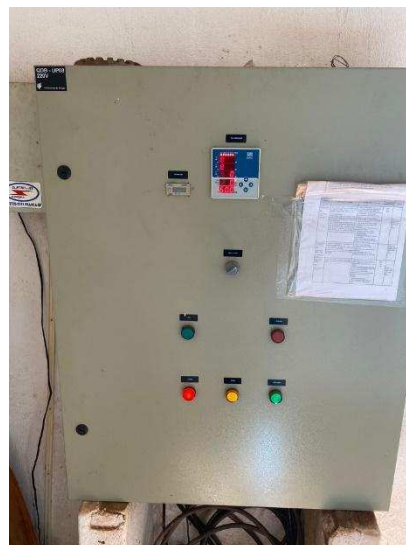
Figura 44 – Painel de Comando.
