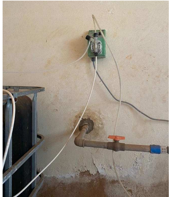
Figura 85 – Bomba dosadora de cloro.
