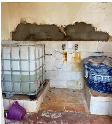
Figura 38 – Dosagem de cloro e flúor.
