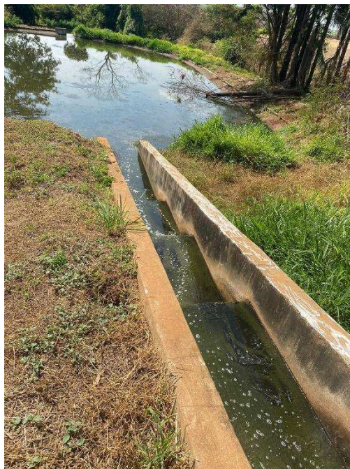
Figura 139 – Entrada do efluente na 2ª Lagoa Facultativa.
