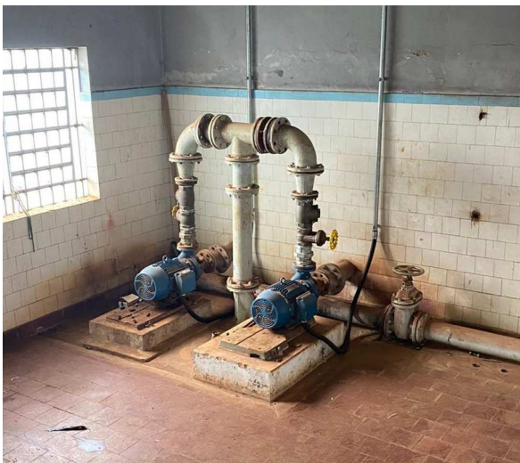
Figura 34 – Elevatórias para o poço UP06.
