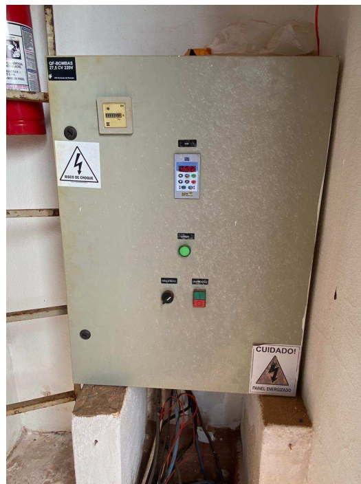
Figura 54 – Painel de comando.
