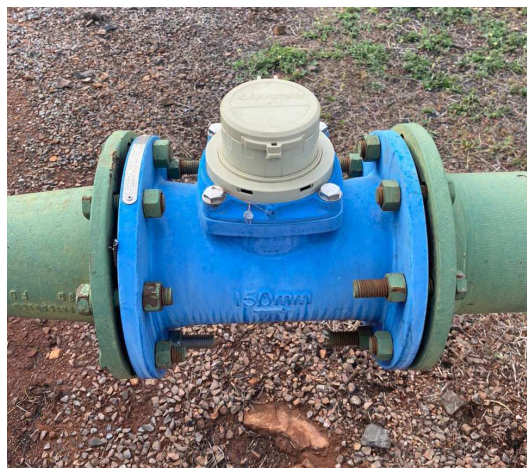
Figura 37 – Macromedidor Poço UP06.
