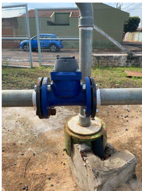
Figura 50 – Macromedidor poço UP 09.
