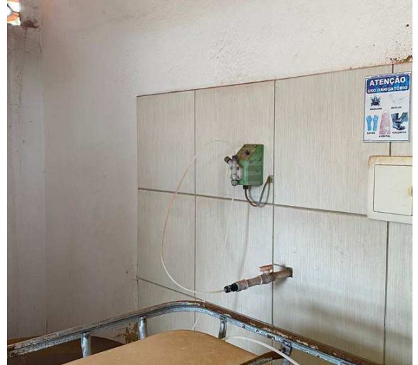
Figura 61 – Bomba dosadora de flúor.
