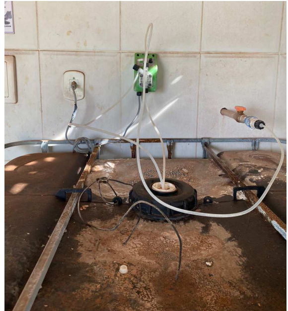
Figura 69 – Bomba dosadora de cloro.
