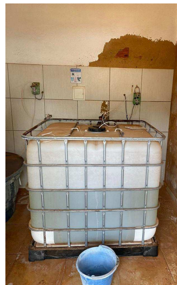
Figura 59 – Dosagem de cloro e flúor.
