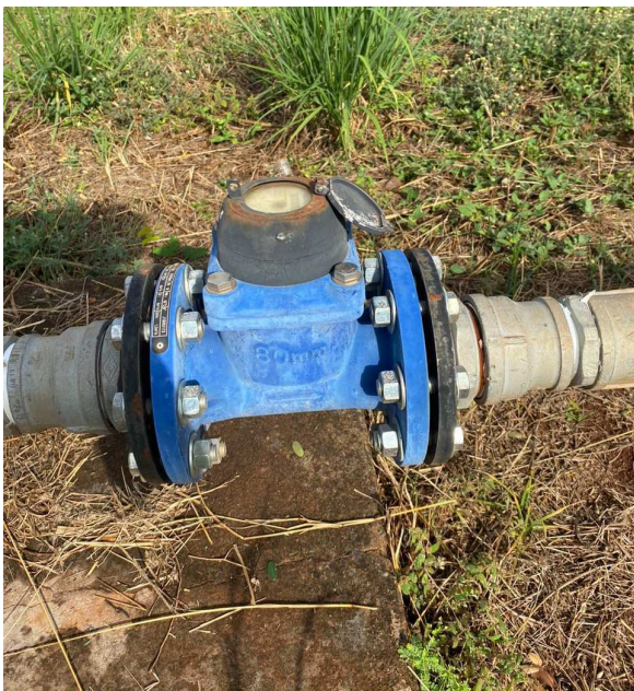
Figura 73 – Macromedidor poço UP 12.
