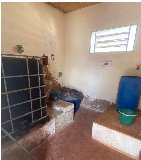
Figura 84 – Dosagem de cloro e flúor.
