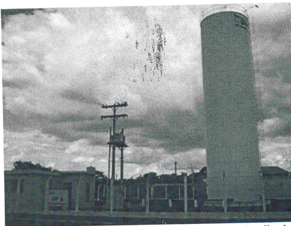
Imagem 3 - UP06 poço e Reservatório, ambos localizados em Guará/SP.
