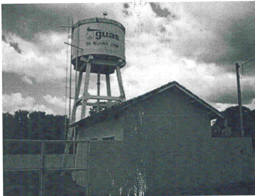
Imagem 1 - UP01 Poço e Reservatório, ambos localizados em Pioneiros, município de Guará/SP.
